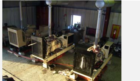
La Sala de generadores de la BCAA, funcionando a pleno.
